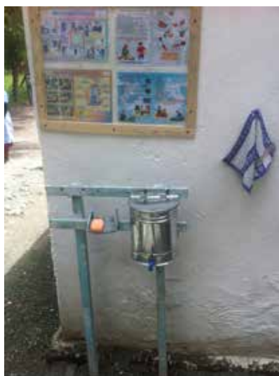
Une installation sanitaire avec instructions dans un village tadjik
